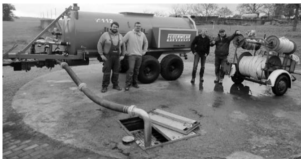
Löschfass mit Löschwasserzisterne in Hambrunn
